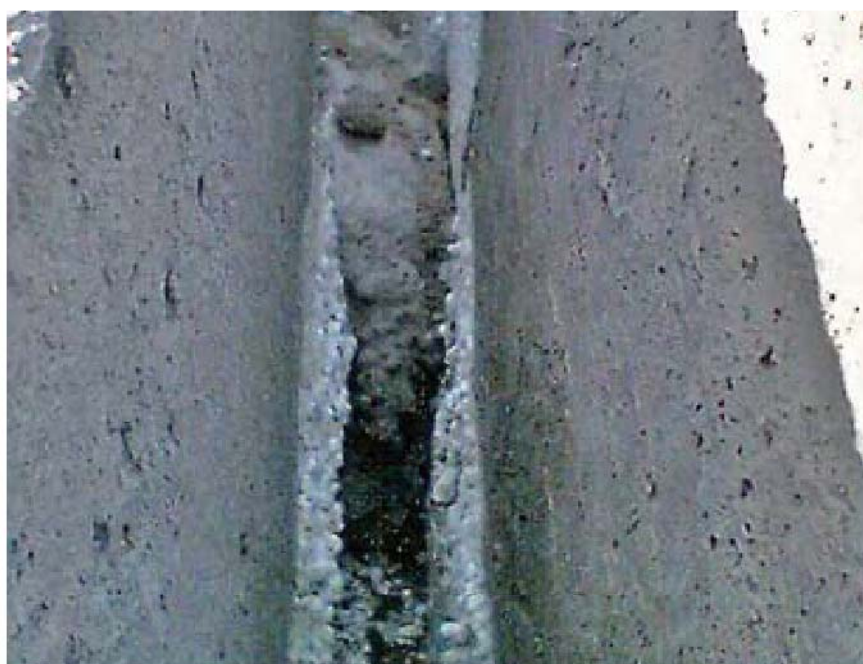
Gjutspill kortsluter mellan bottenplattor.
