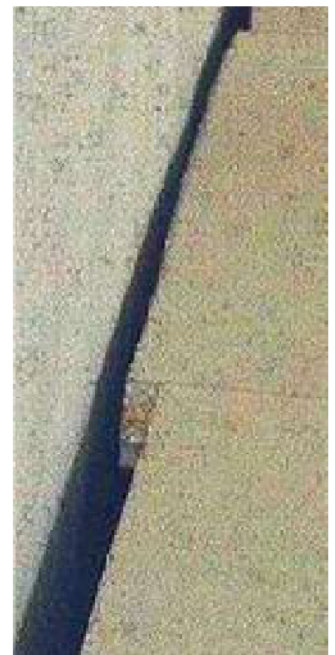
Flytande golv ska inte ligga emot vägg.
